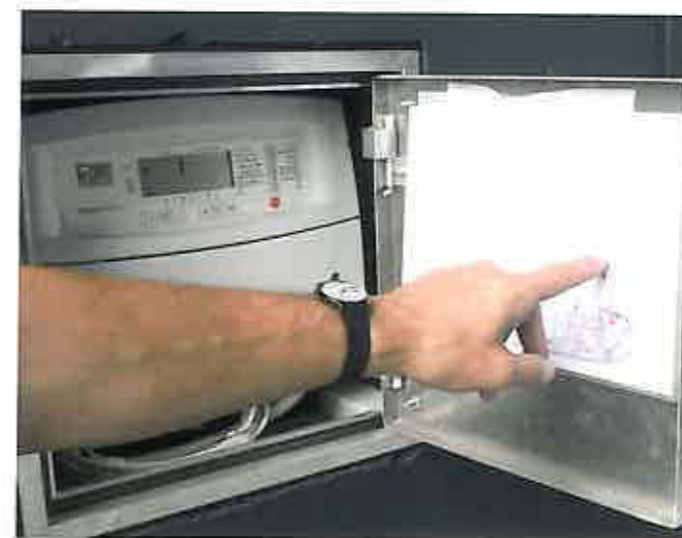
Auf einen Blick und mit einem Handgriff lassen sich Rasensprenger als auch Rasenentwässerungsanlage in Betrieb setzen.
