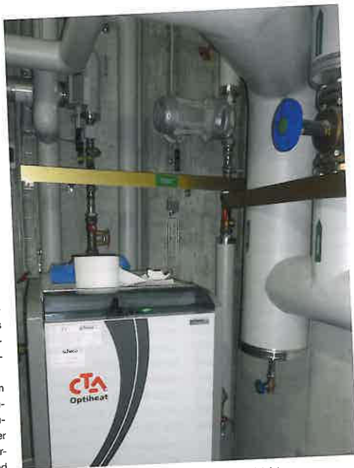
Mit einer Wärmepumpe wird geheizt, wo es erforderlich ist.
