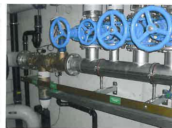
Saubere und fachtechnisch schöne Installationen, wobei der Verteiler aus vereinfachenden Gründen direkt bei der Firma Nussbaum in Ofen zusammengestellt worden ist
