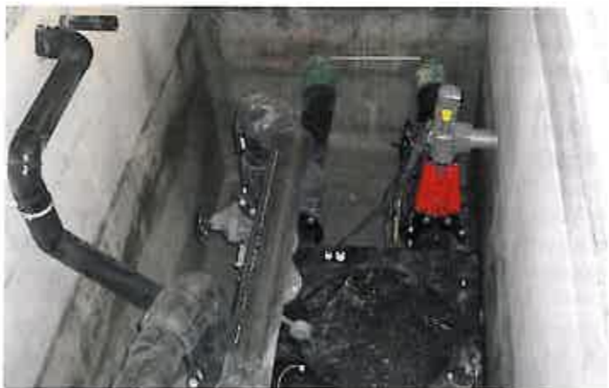
Blick in die Tiefe der Hebeanlage
