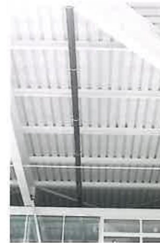
Pluvia an der Decke. Die Abwasserentsorgung bot hohe Anforderungen, denn die Durchmesser betragen bis zu 350 mm.
