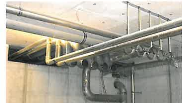
Saubere und übersichtliche Rohrmontage mit zum Teil sehr grossen Dimensionen
