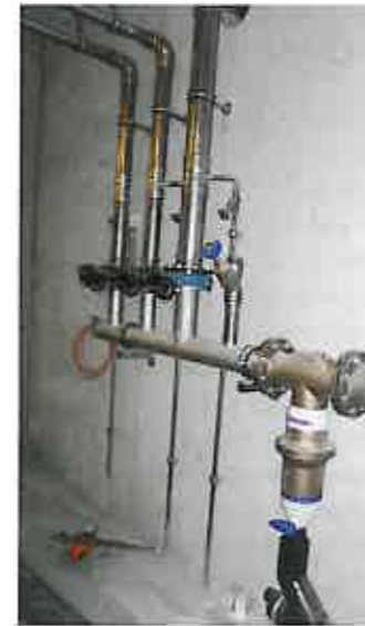
Immer wieder dezentrale Verteiler (Nussbaum AG), bedingt durch die Mehrfachnutzung von Einrichtungen und die grossen Distanzen.
